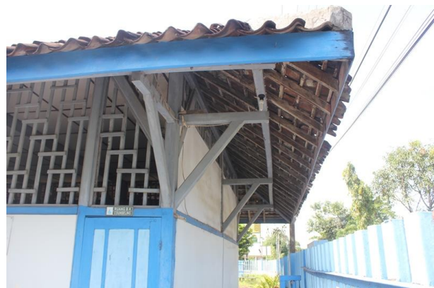
Ram-raman pada dinding barat bangunan SMP Kanisius Bambanglipura yang sebagian ditutup dengan tripleks serta ram-raman pada dinding utara yang tidak ditutup dengan
