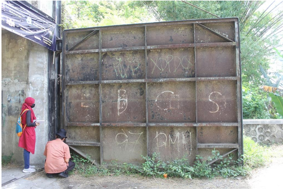
Pintu Penahan Banjir Nambangan di Padukuhan Nangsri, Kalurahan Srihardono, Kapanewon Pundong, Kabupaten Bantul (Sumber: TPCB Kab. Bantul, 2021)
