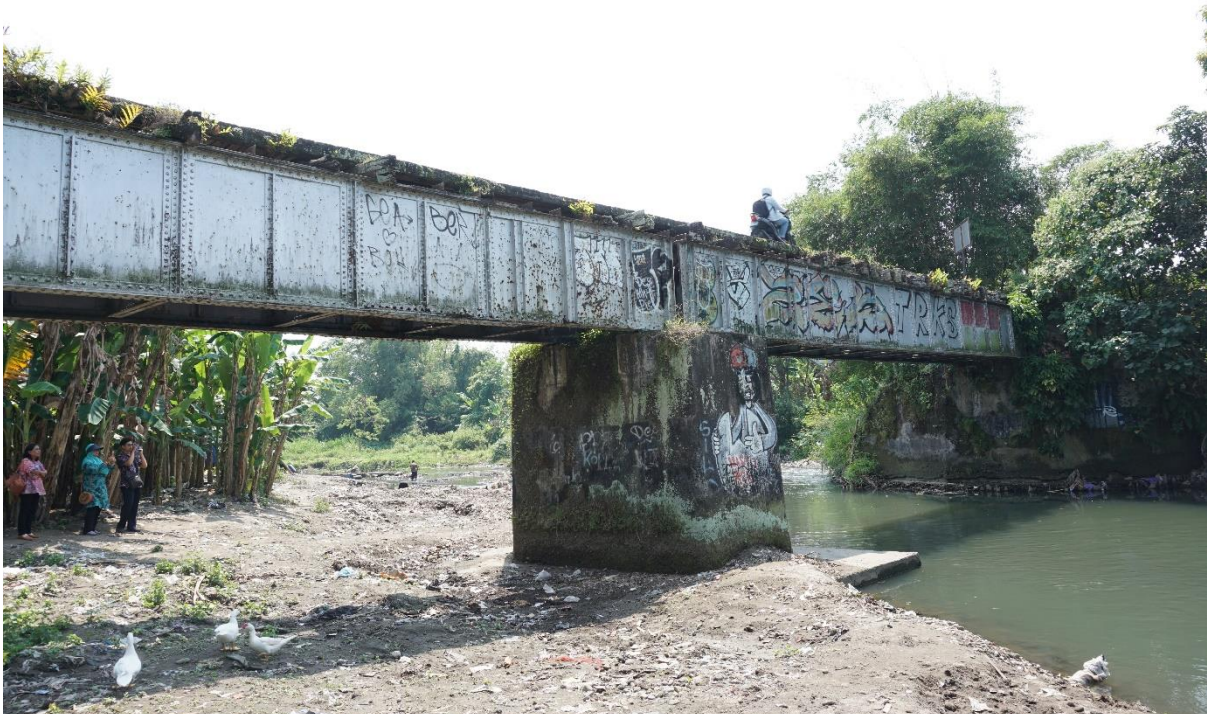
Struktur Jembatan Winongo dilihat dari arah tenggara Sumber: Tim Ahli Cagar Budaya Kabupaten Bantul, 2018
