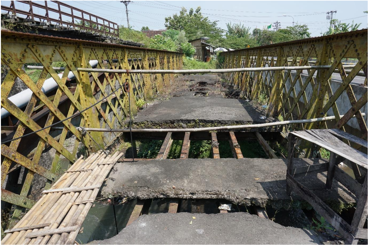
Kondisi Jembatan Kreteg Abang Madukismo Sumber: Tim Ahli Cagar Budaya Kabupaten Bantul, 2018
